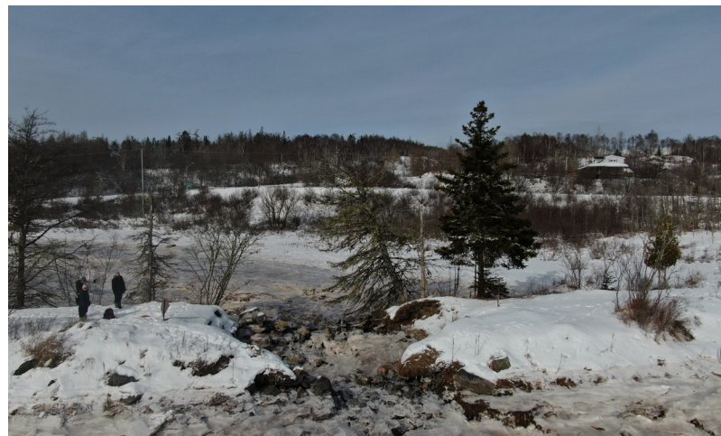
Ponceau de la voie ferrée effondré le long de la branche ouest de la rivière Musquash. Crédit photo : Eastern Charlotte Waterways.
